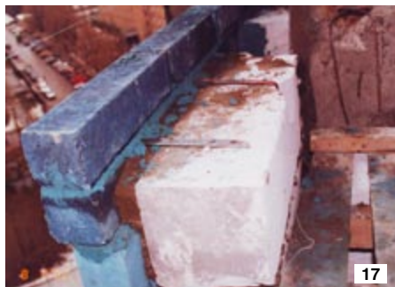
Рис. 17. Связи из стальной полосы без антикоррозионного покрытия
