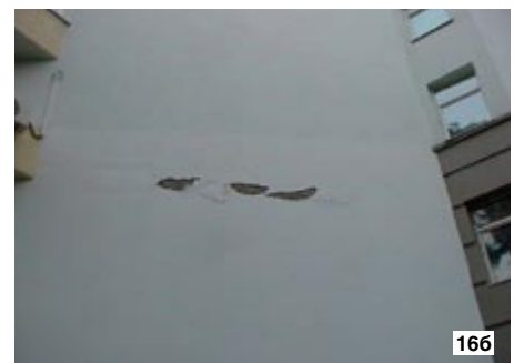
Рис. 16. Отслоение штукатурного слоя, выполненного по стальной сетке, перекрывающей зазор между низом плиты перекрытия и подведенной под нее кладкой лицевого слоя: а) ул. Плющиха, 2003 г.; б) ул. 2-я Ямская, 2004 г.
