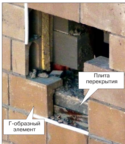
Рис. 4. Трехслойная наружная стена с наружным слоем из вибропрессованных блоков фирмы «РОССЕР» с ненадежным опиранием кладки на перекрытие через Г-образный элемент
