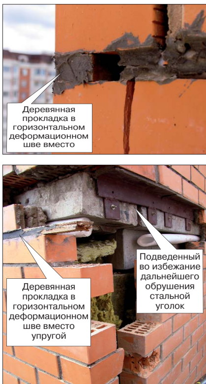
Рис. 6. Некачественное выполнение горизонтального деформационного шва, вследствие непродуманного проектного решения
