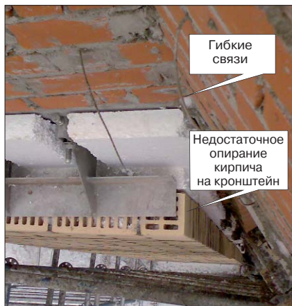
Рис. 5. Некачественное опирание лицевого слоя на кронштейны фирмы «Халфен Деха», некачественная установка гибких связей
